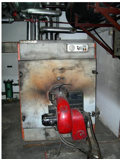
Slika 4: Dotrajan kotel v novem delu OŠ Krmelj
