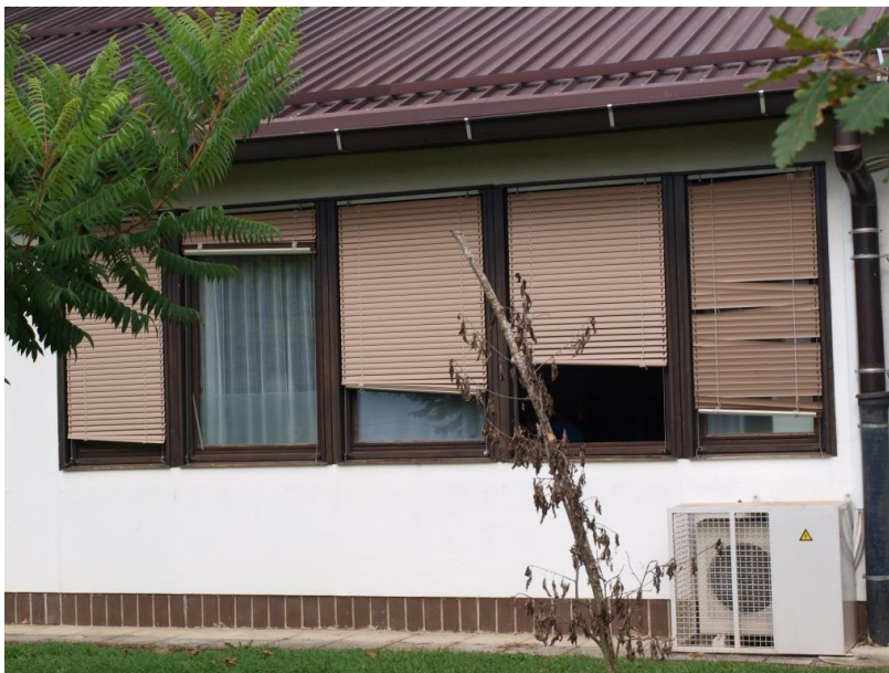
Slika 7: Dotrajana okna na OŠ Boštanj
